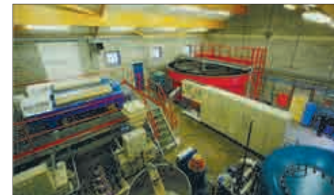
Aéroflottation des boues et centrifugation
