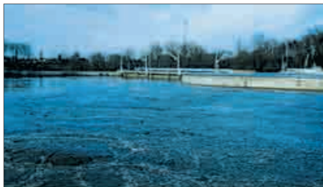
Bassin biologique à boues actives
